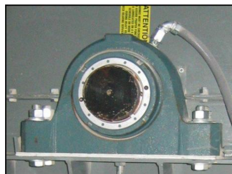
sensore installato sul cuscinetto del trasportatore
