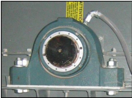
sensore installato sul cuscinetto del trasportatore
